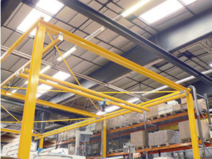
Poutres monorail et ponts suspendus, mono
